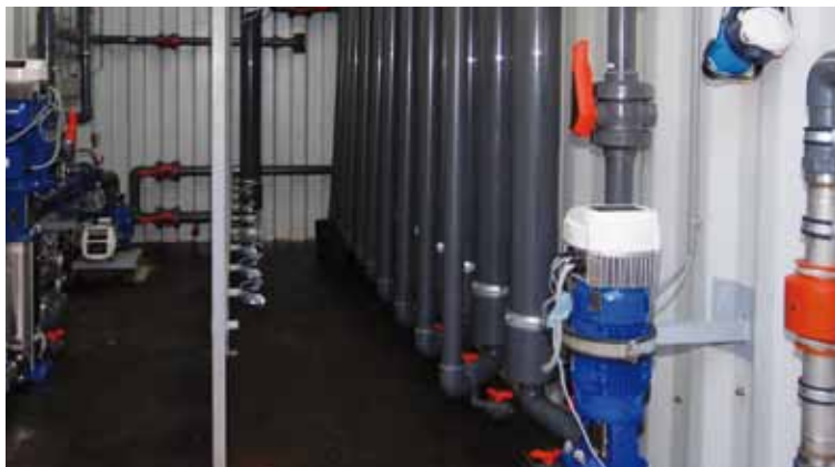
Das Innere der Pilotanlage
