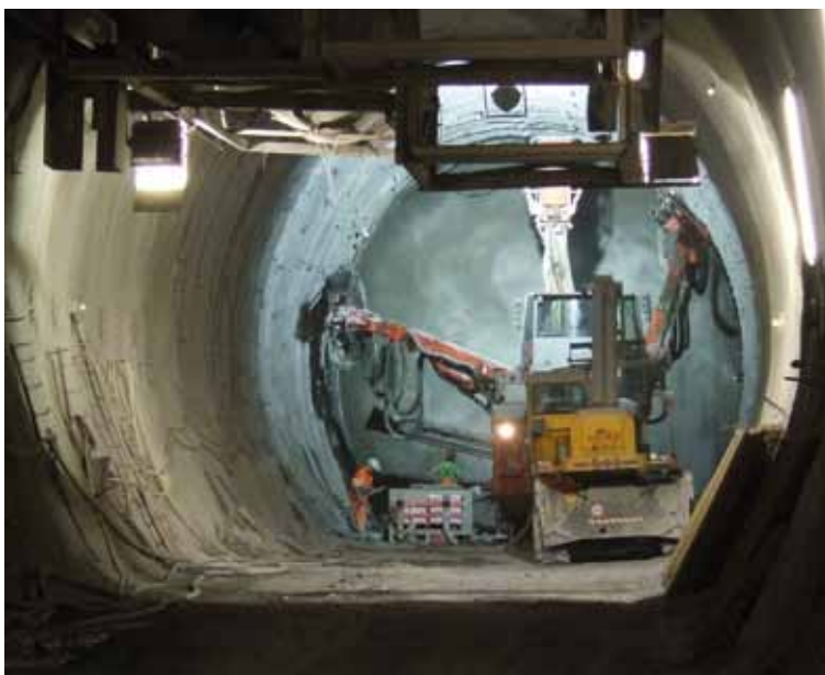
Ausbildung und Forschung sollen im neuen Zentrum am Berg von Beginn an möglich sein.
