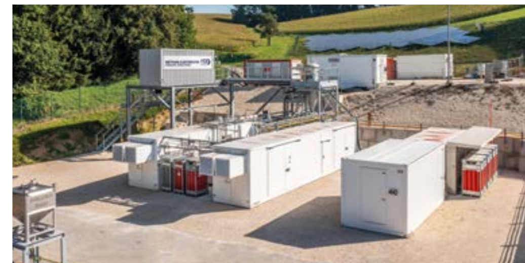
Die Anlage der RAG in Kremsmünster
