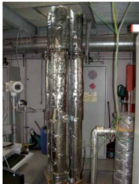
Druckreaktoren zur Untersuchung des Gemischverhaltens von H_2/CH_4 -Verbindungen
