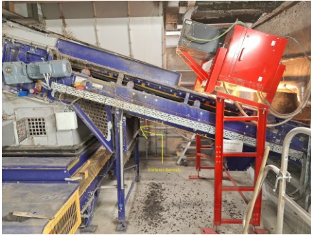
Abbildung 1: Sensoreinheit in der Aufbereitungsanlage.
