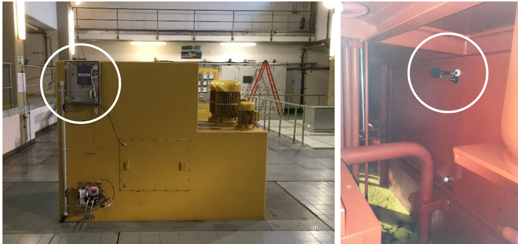
Mikrofonposition beim Regelölbehälter der Maschine 2 im Kraftwerk Rabenstein
