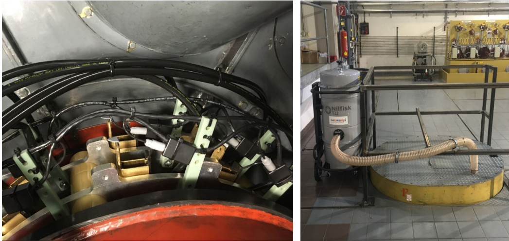
Bürstenbrücke mit Absaugsystem inkl. Überwachung bei Maschine 1 im Kraftwerk Rabenstein
